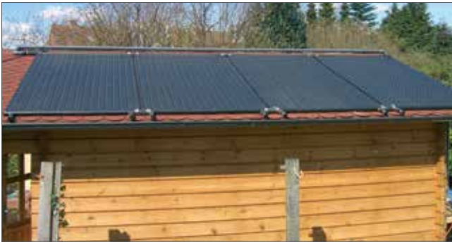
Kleine installatie Nordhorn
